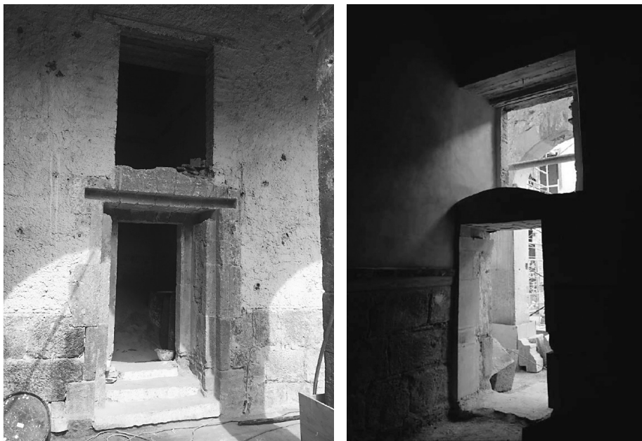
Vanos de celdas
