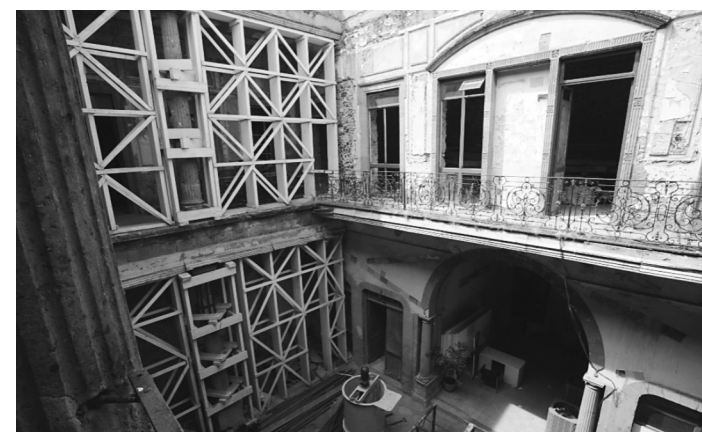
Corredores de la Antigua Escuela Secundaria antes de la intervención Fotografías: Archivo personal
